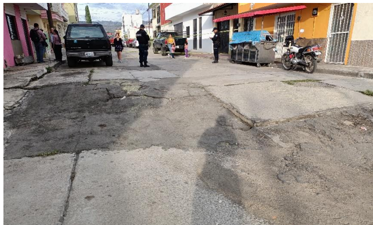
Fotografía: Daños en vialidades por falla y reparadas constantemente (UMPCYB 2022).
