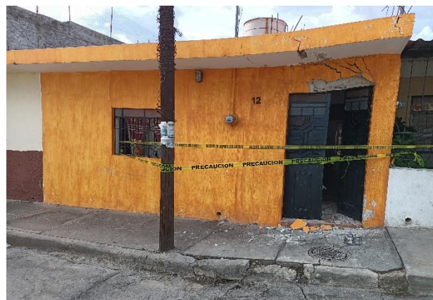
Fotografía: Daños en banquetas y casas-habitación (UMPCYB 2022).
