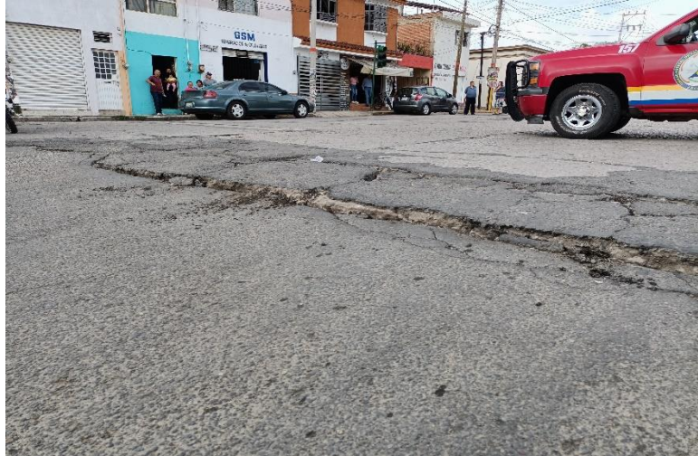
Fotografía Daños en vialidades por fallamiento generando desplazamientos hasta de 50 cm (Fuente: UMPCYB 2022).
