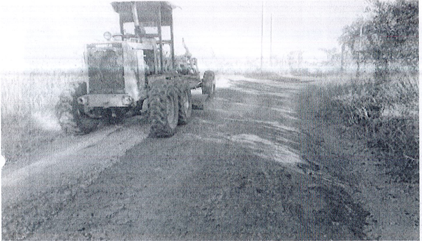
Mantenimiento del camino de acceso al Relleno Sanitario de Zapotlán El Grande.
