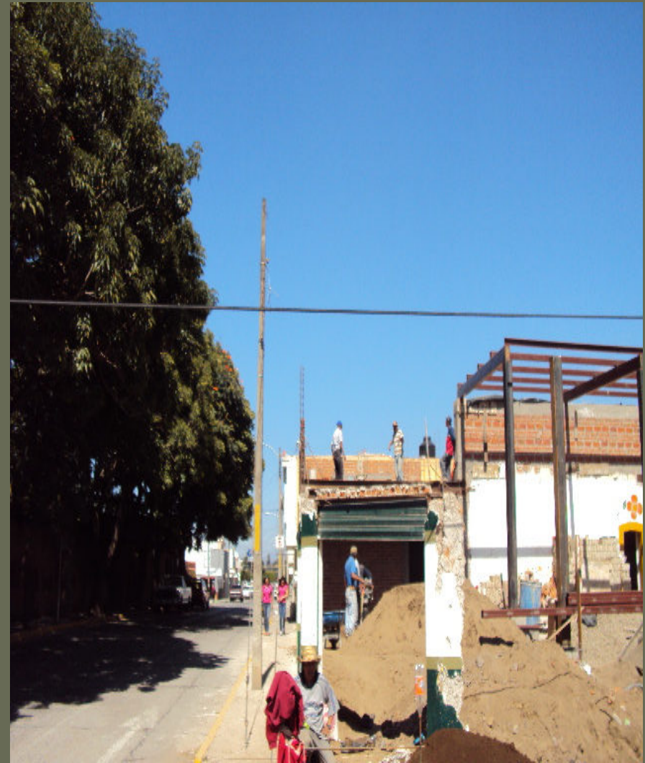
RETIRO DE LUMINARIA EN CALLE 16 DE SEPTIEMBRE ESQ. CALZADA MADERO Y CARRANZA POR RETIRO DE POSTE DE C.F.E
