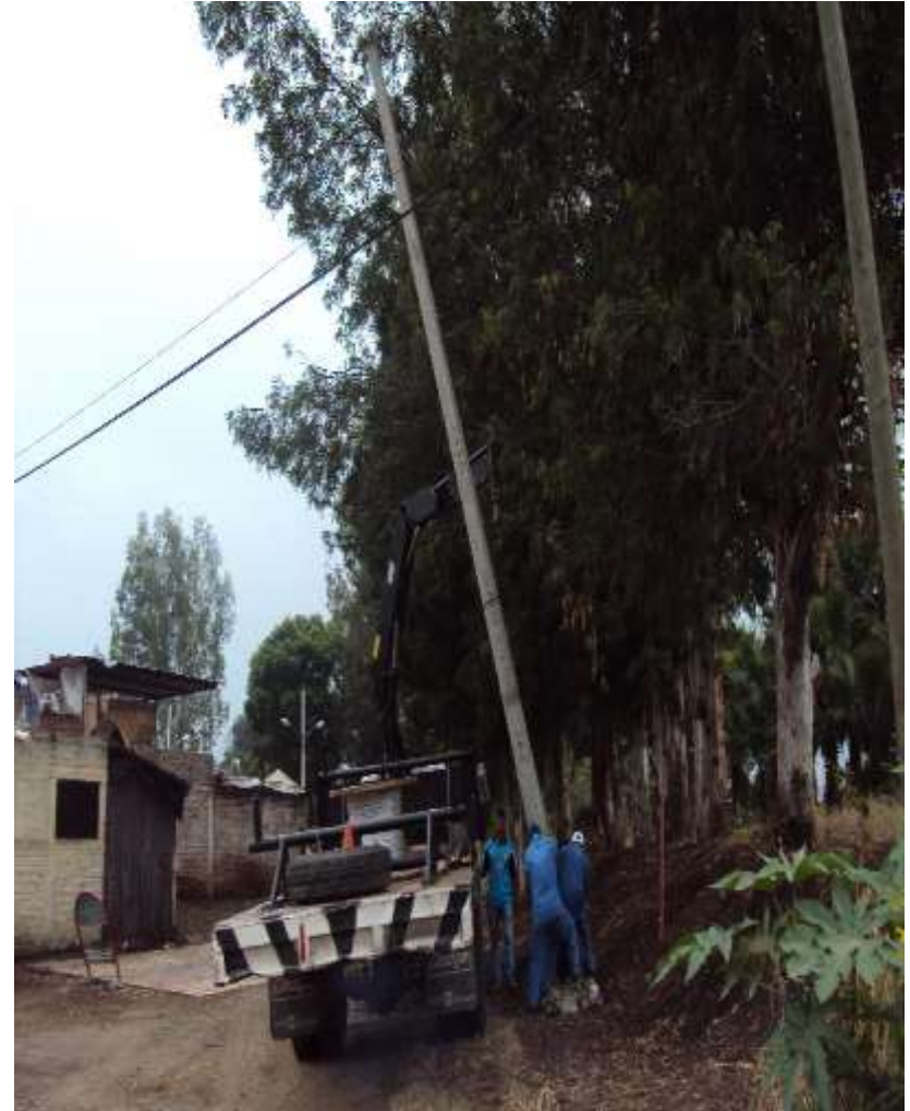
CAMBIO DE POSTE DE CONCRETO CALLE , AGUSTÍN YAÑEZ ESQUINA EULOGIO PARRA EN LA COL. PROVIPO
